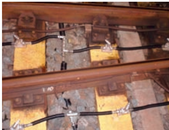
分岐器のレールに設置されたレールミストのノズル
