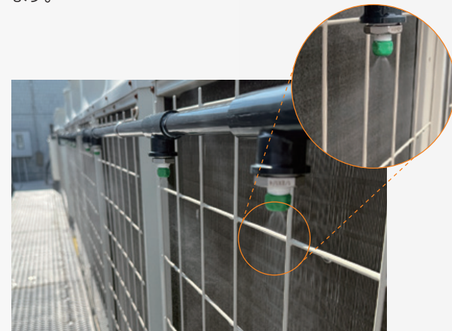
能美防災(株)本社屋上の室外機に設置
