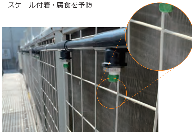
能美防災(株)本社屋上の室外機に設置
