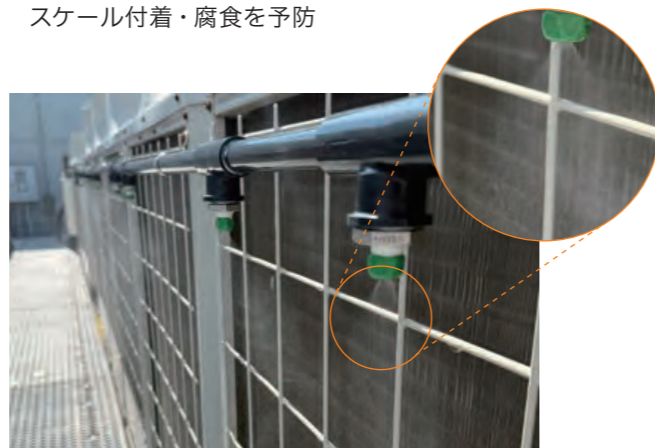
能美防災 (株) 本社屋上の室外機に設置
